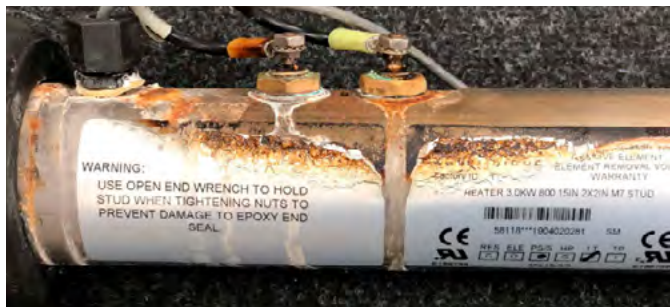
Eroderet varmelegeme med tærede pakninger.
